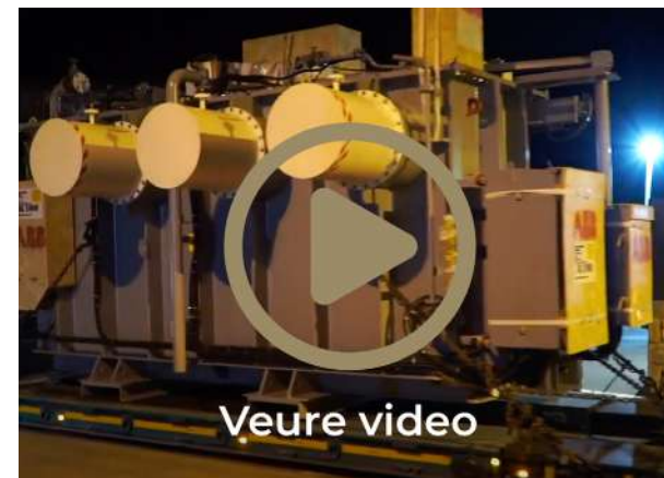
Transformadors d'alta tensió - La Gonarda
